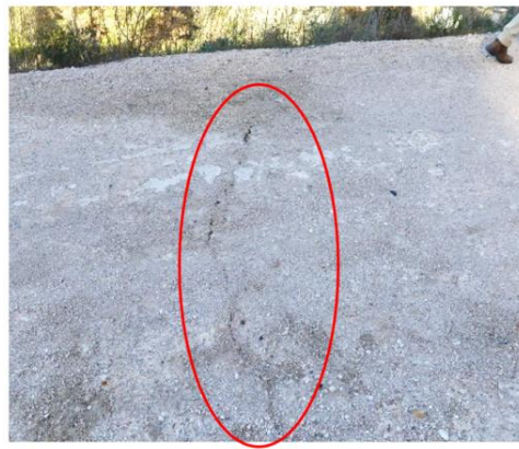
Illustration 19 : Indice de redémarrage du phénomène de fissuration perpendiculairement à la banquette n° 4 du teril du Grapon – Commune de Meyreuil (13).
