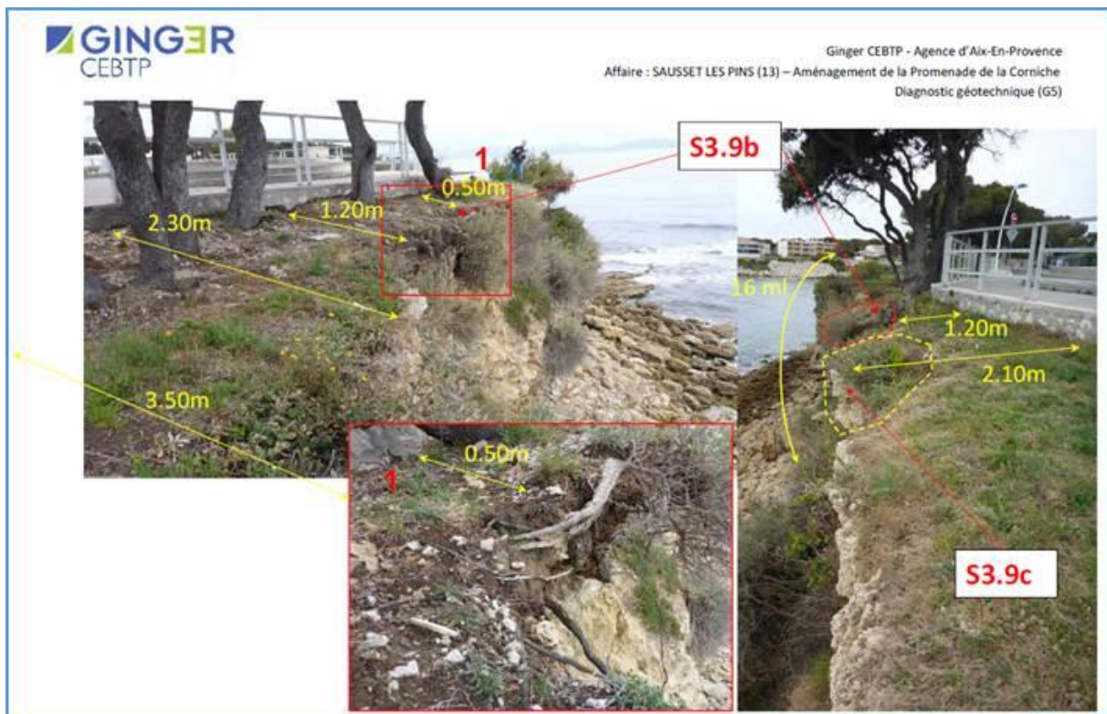
Figure 4 : Localisation des instabilités au niveau du belvédère (Source : MAMP)
