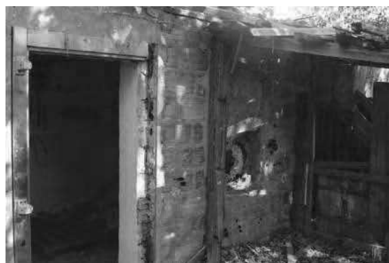
Cabanon nord-ouest très dégradé avec une partie sans toiture.
