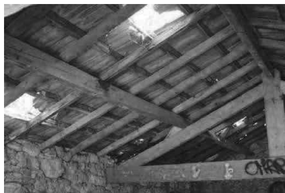
Toiture dégradée du cabanon sud-est. Ce cabanon n'est pas favorable aux chiroptères.
