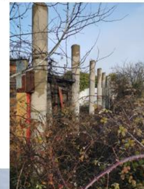
Partie sud-est non visitée : bâtiment en ruine, caravane
