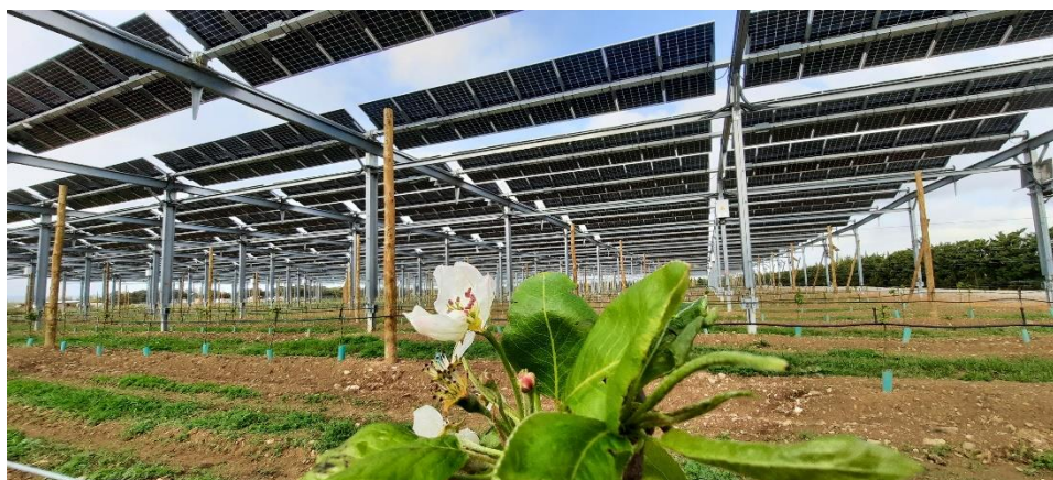
Installation agrivoltaïque Sun'Agri sur poiriers – Llupia (66)
