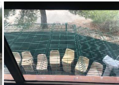
Un bâtiment non adapté aux usages qu'il accueille : manque de place de stockage, cuisine plus utilisée, etc.
