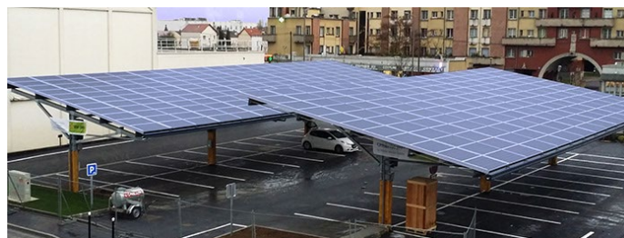
En moyenne 1m 2 de capteurs photovoltaïques (amphore, cristallin) = 125 KWh/an
