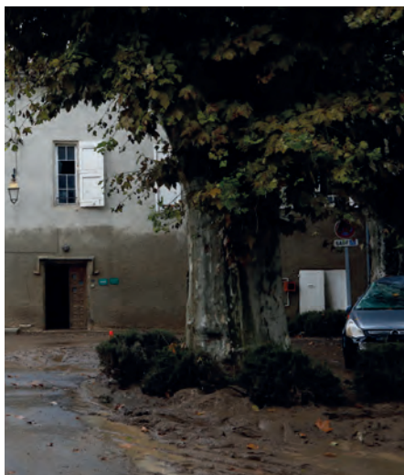
Une laisse de crue sur un bâtiment du centre de Villegailhenc © Photothèque IRMa / S. Gominet
